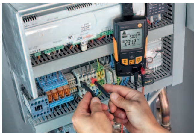
Проверка напряжения в щитке автоматики теплового насоса
