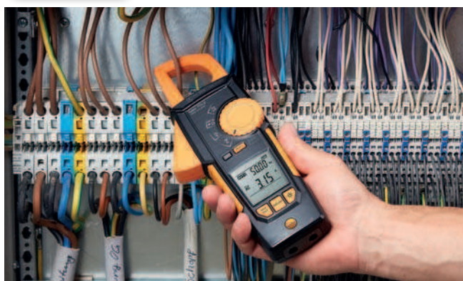
Измерение силы тока в распределительном щитке
