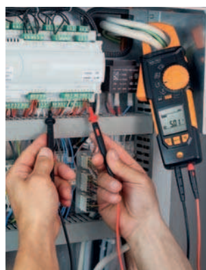
Измерение напряжения в распределительном щитке теплового насоса путем подвешивания прибора
