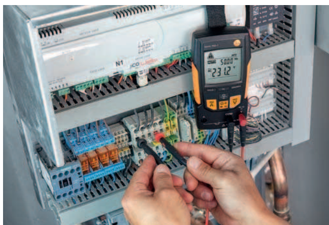
Проверка напряжения в щитке автоматики теплового насоса
