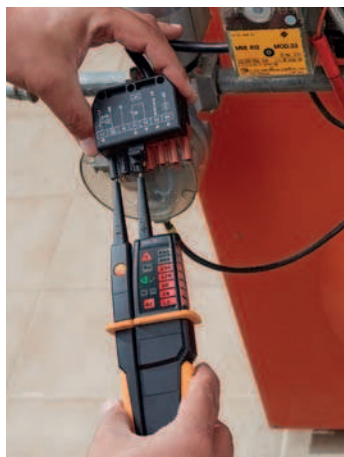
Проверка напряжения на разъеме горелки отопительных котлов с testo 750
