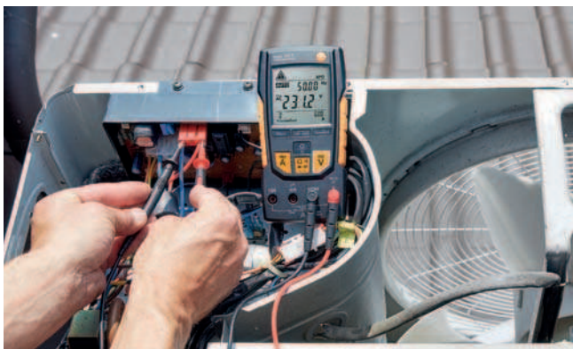
Измерение напряжения на наружном блоке холодильной установки с testo 760
