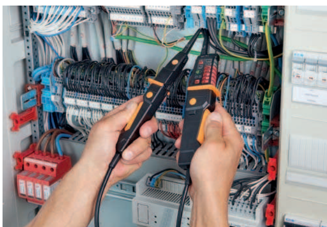
Измерение напряжения в распределительном щитке
