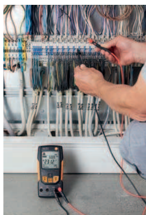
Проверка напряжения в распределительном щитке
