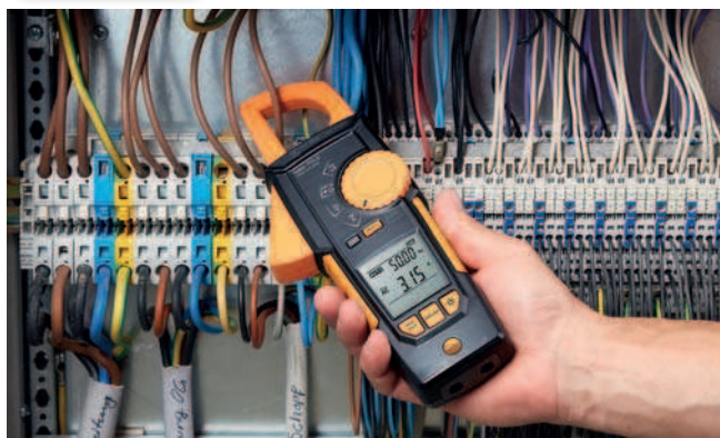
Измерение силы тока в распределительном щитке
