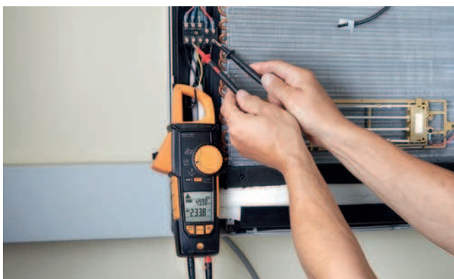
Измерение напряжения на блоке кондиционера с testo 770
