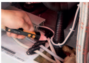
Первый тест подачи напряжения на компрессоре
